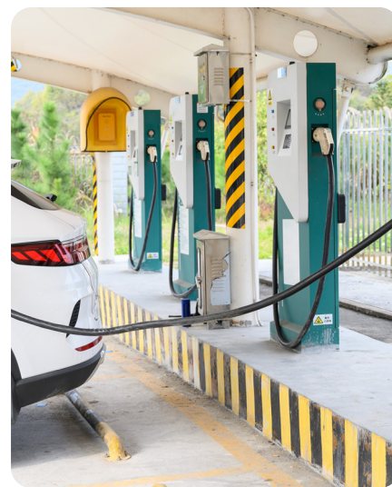
Station de recharge pour VE
